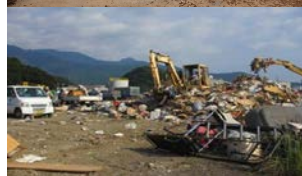
土砂混じりのがれき (宇和島市)
