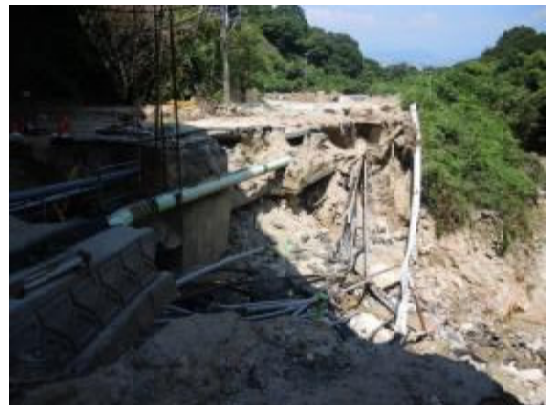
県道34号線の陥没
