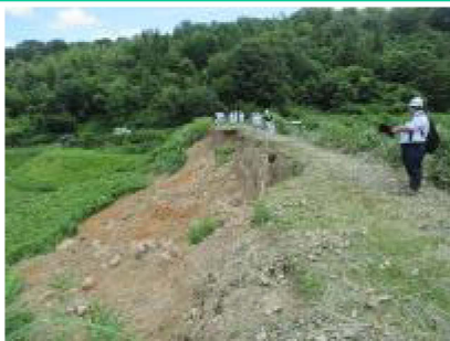
江田池:堤体崩壊部堤体左岸より望む
