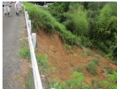
山地下池:堤体崩壊部右岸側より望む
