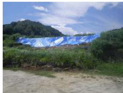
半三池:堤体崩壊部(下流より望む)
