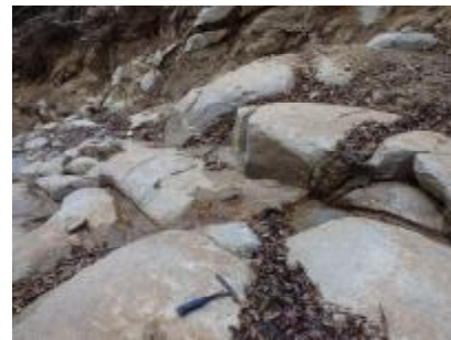
Ch級：溪床に露出したもの（2015年2月）
