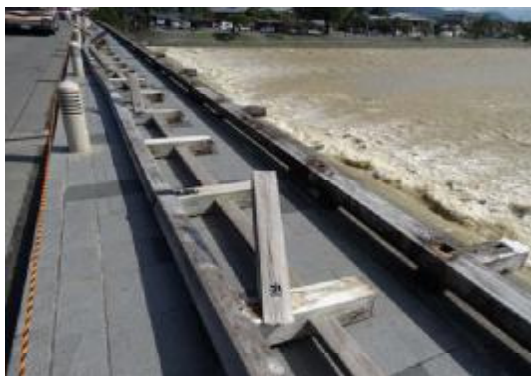
橋梁の欄干の倒壊 京都市（京都大 八木教授撮影）
