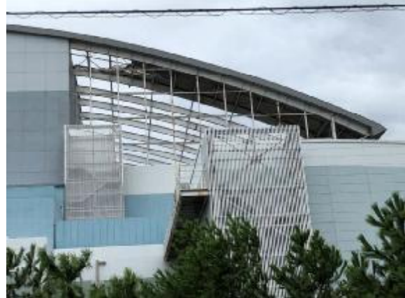
鋼板製屋根のはく離 (摂南大 池内研究室提供)
