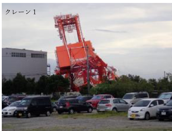
クレーンの倒壊 兵庫県西宮市（神戸大 竹内助教撮影）
