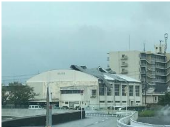
鋼板製屋根のはく離 大阪府岸和田市春木体育館 (高知大 野田教授撮影)
