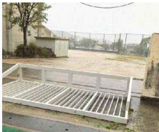
学校門扉の転倒 大阪府貝塚市 (日本建築総合試験所 前田氏撮影)
