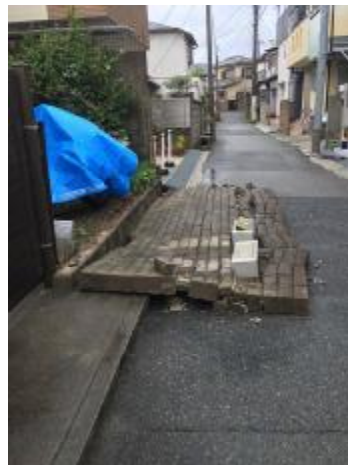
ブロック塀の倒壊 兵庫県川西市 （大阪市大 谷口研究室撮影）
