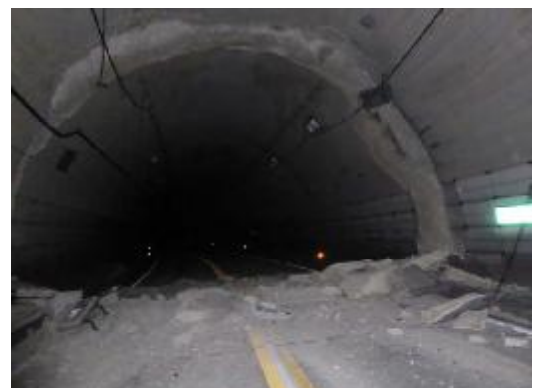
2016年熊本地震県道28号線横山トンネルの被害状況（撮影：小長井一男）
