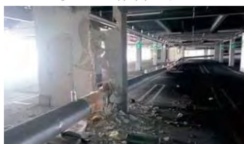
③大口径配管の脱落
