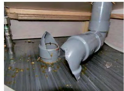
③排水管破断
