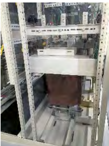
①トランス脱落
