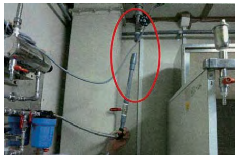
②器具接続給水管破断
