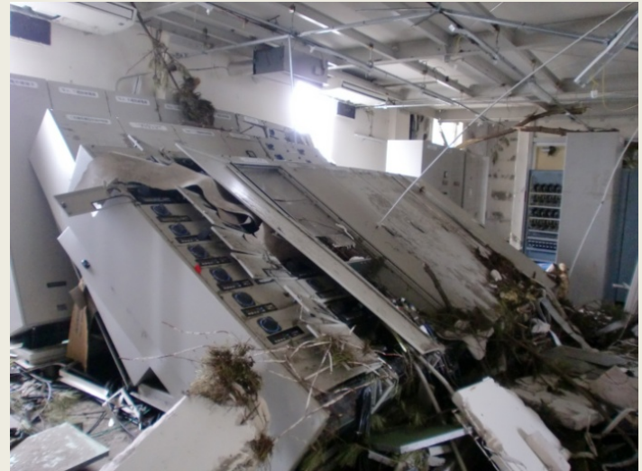
仙台市南蒲生浄化センター電気室、2011年5月
