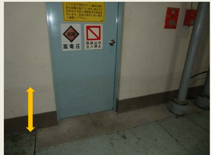
宮城県仙塩浄化センター電気室、2011年5月
