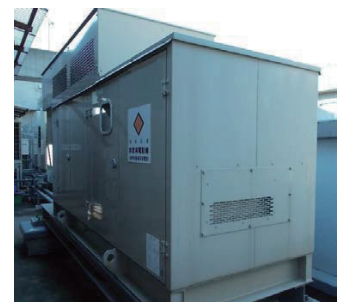
(非常用自家発電装置)
