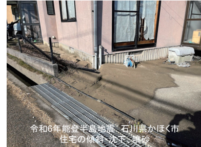
令和6年能登半島地震 石川県内灘町 住宅塀の傾斜、道路の傾斜、舗装の圧縮
