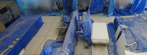
給食センターの被害
